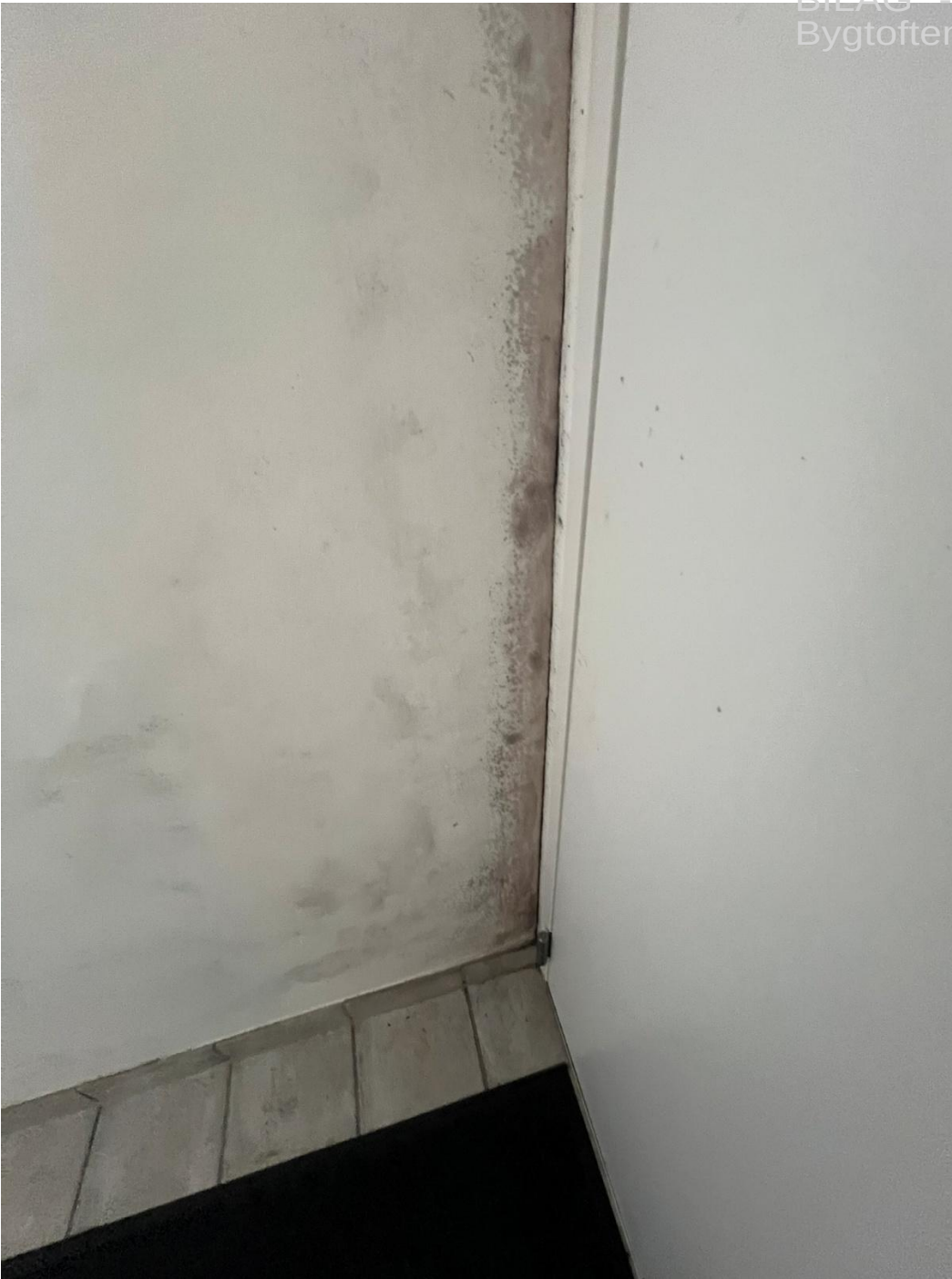
Foto 4 – skimmel på gavlvæg ved yderdør.
