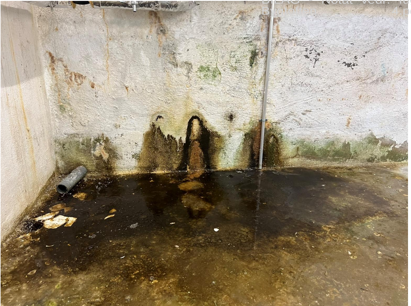
Foto 7 - viser at der løber vand ud gennem huller i kælder over trapperepose.
