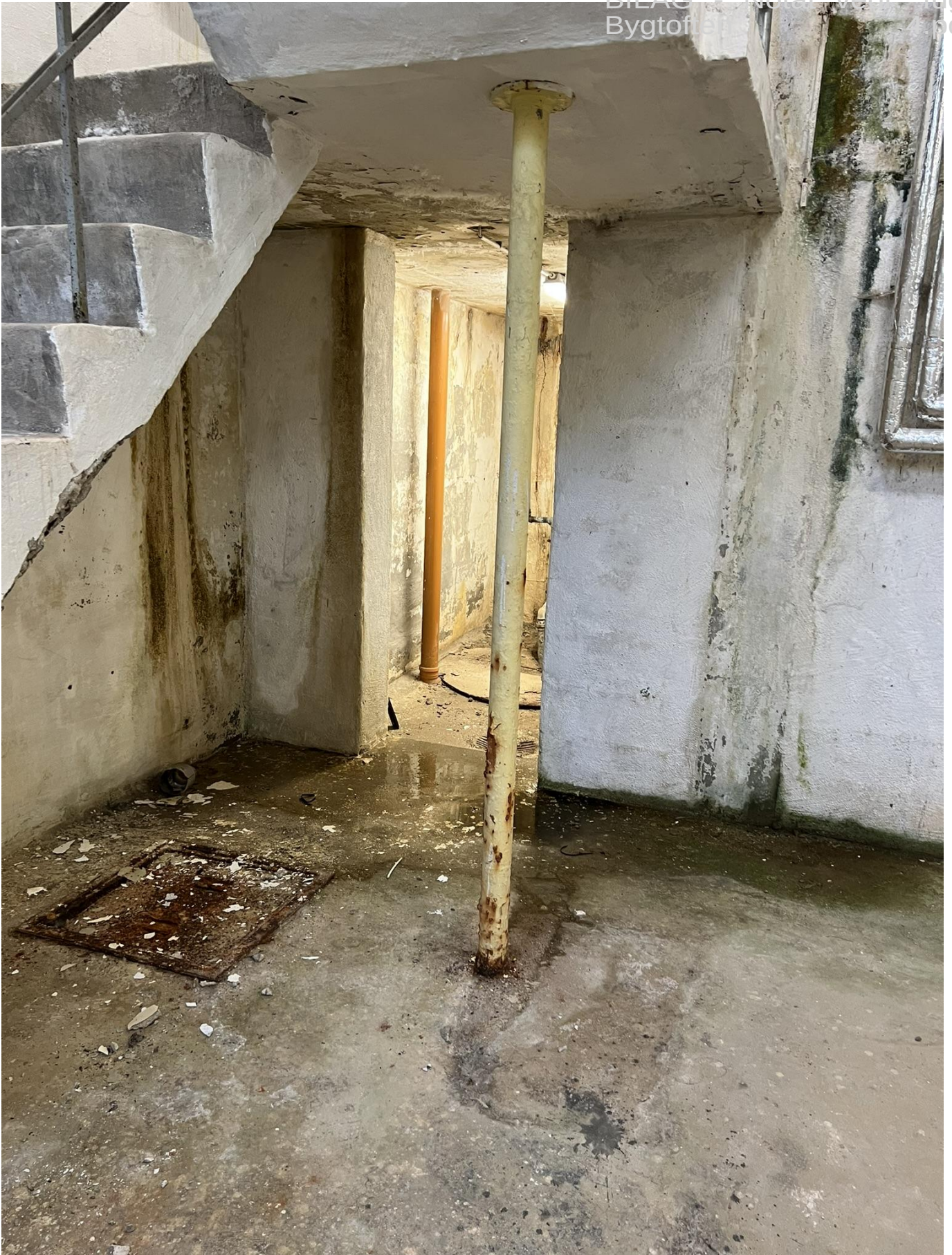
Foto 6 – viser blank vand på gulvet i kælderen
