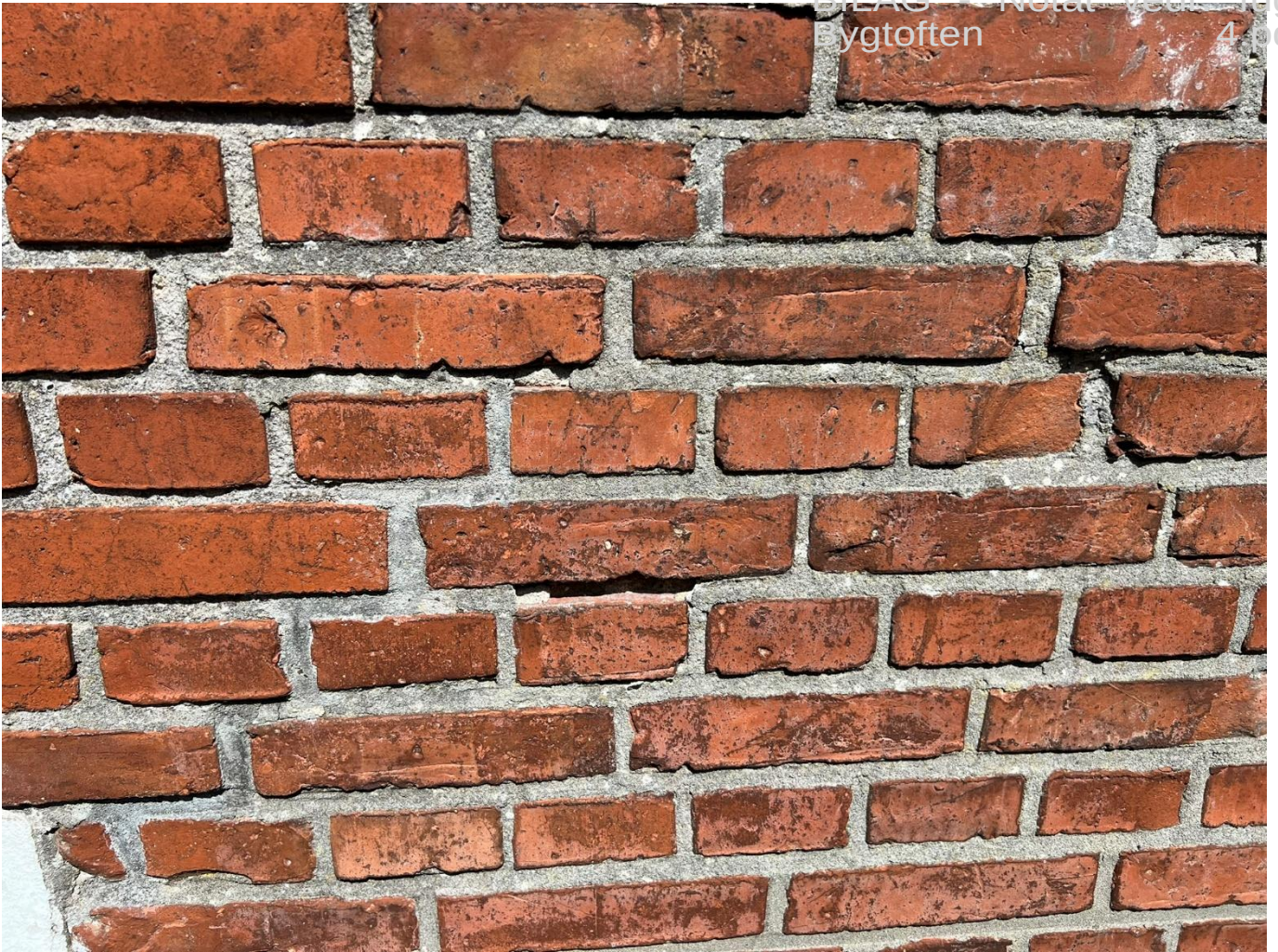
Foto 5 – dårlige murværksfuger på gavl.
