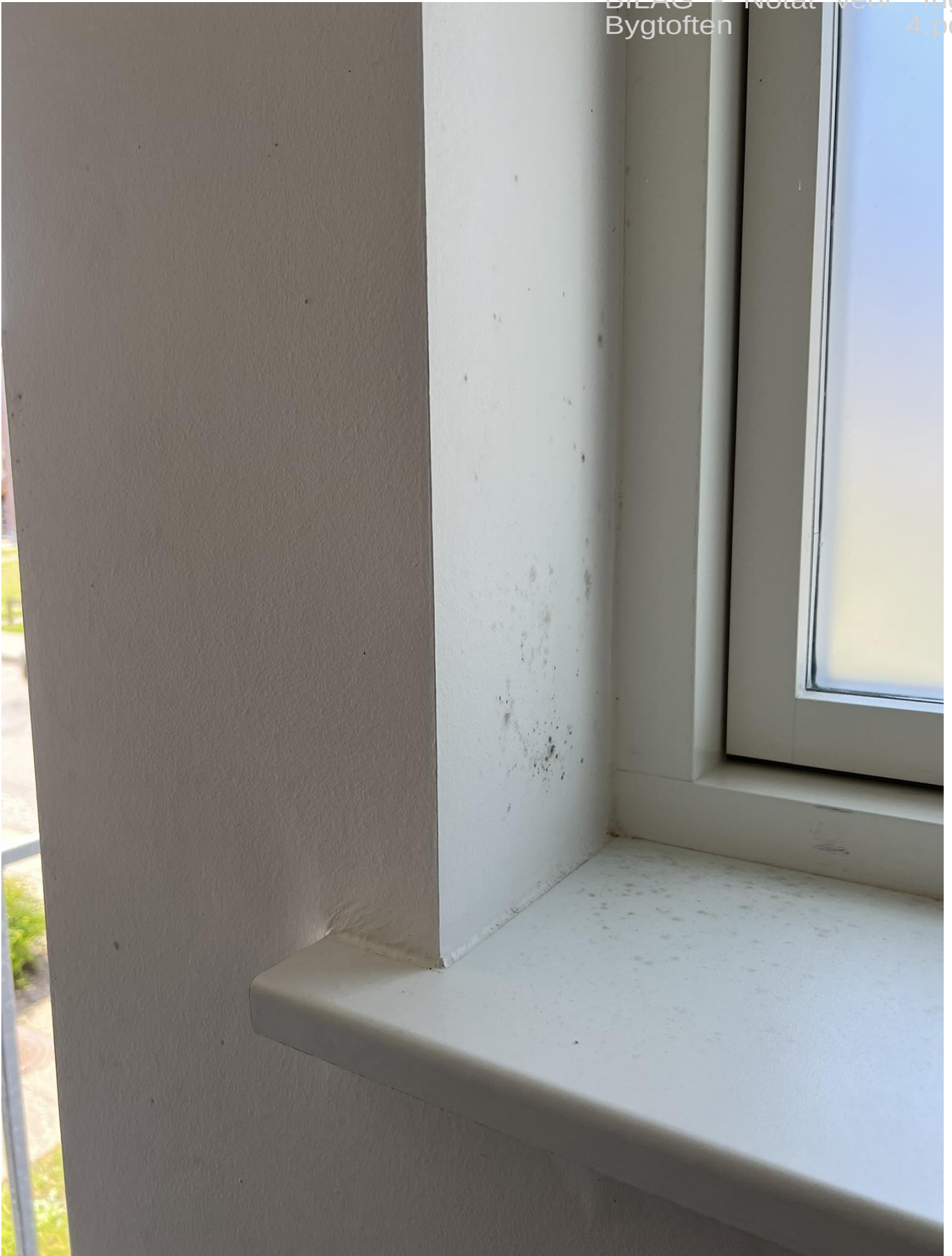
Foto 5 – viser skimmel i vindueslysning.
